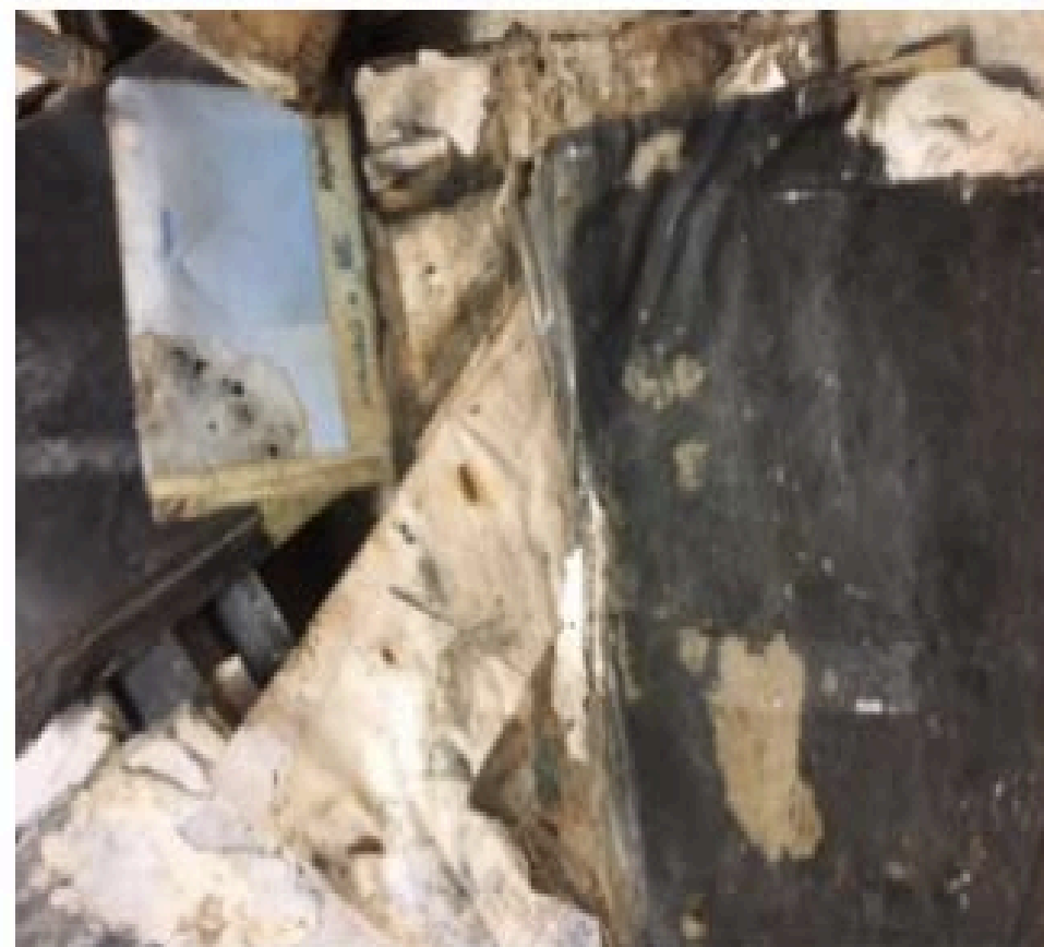
Figura 4 – Prontuários encharcados - infiltração
